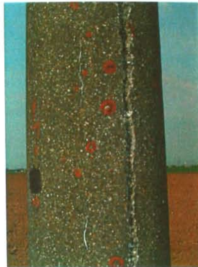
Bild 2: Schäden der Klasse 3
